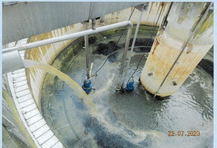
22.07.2020: RÜB2 Inbetriebnahme mit Befüllung bei Regenwetter
