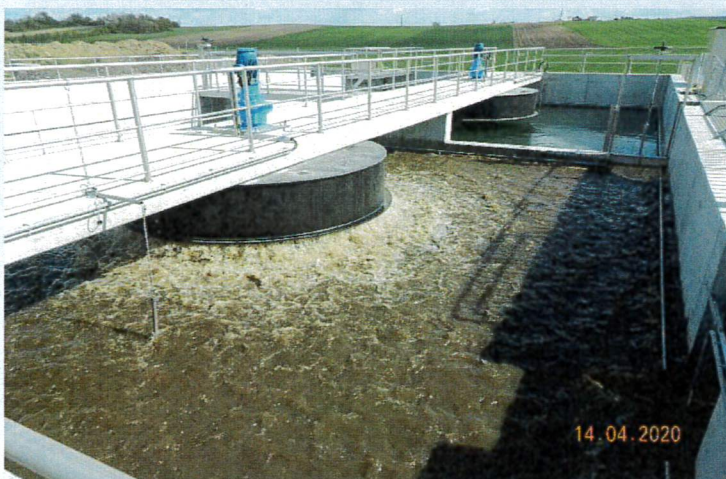
14.04.2020: BB1 Inbetriebnahme nach Reinwassertest
